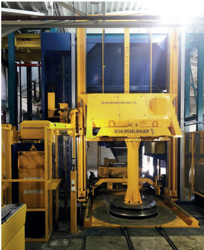
La nouvelle installation de production de type Magic de l'entreprise Zábojník s.r.o. à Veselí nad Moravou.
