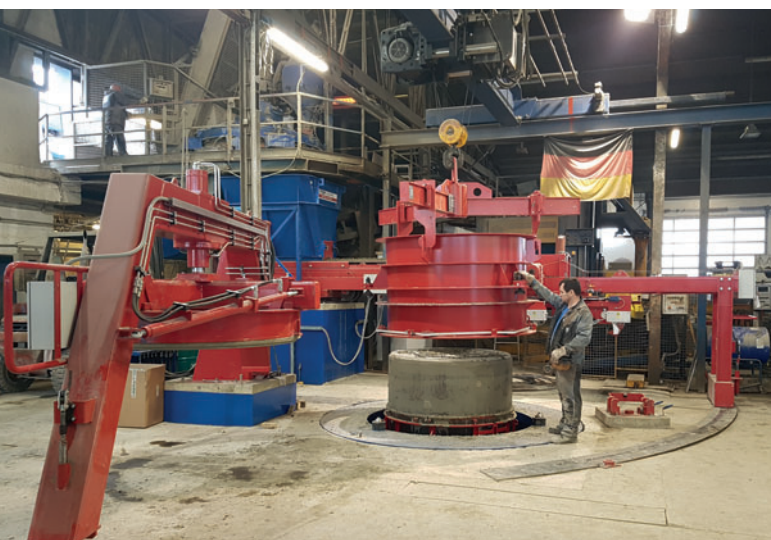
La Variant 2000 C de Prinzing Pfeiffer dans l'usine de béton Kühne
