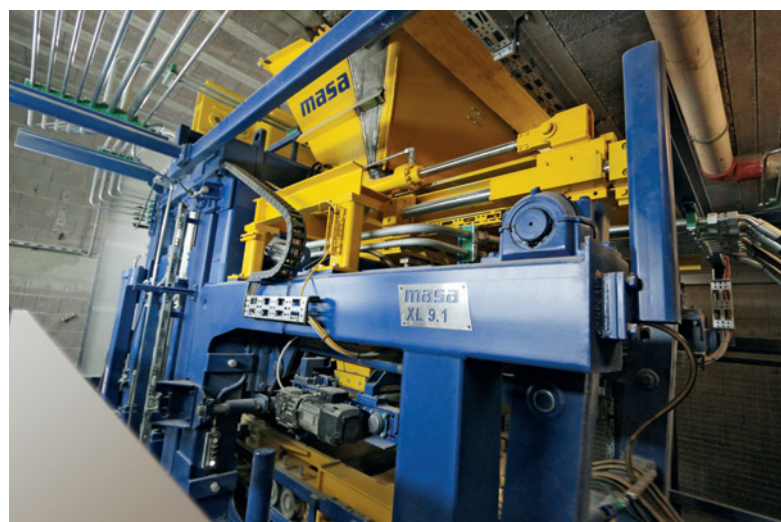
Zamontowany w zasobniku mieszanki betonowej sprawdzony system Multi-Color firmy Masa.
