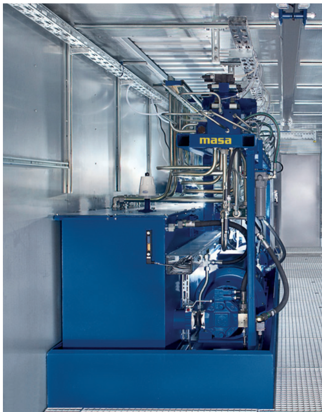
Wszystko na swoim miejscu – Combitainer firmy Masa zawierający układ hydrauliczny i szafki sterownicze.
