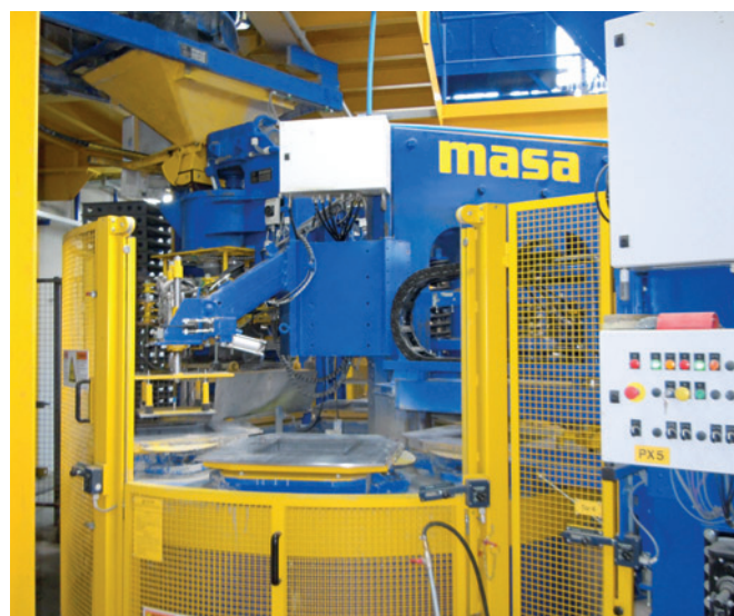
Rozścielacz mieszanki licowej, zasyp mieszanki konstrukcyjnej i stanowisko zmiany formy oraz system zabezpieczeń z opuszczanymi siatkami ochronnymi.
