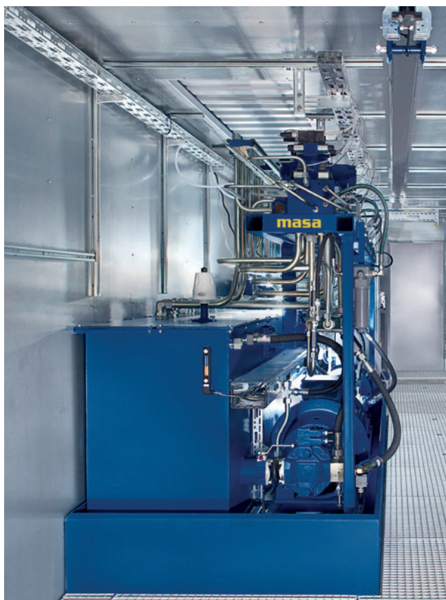
Tutto al suo posto: la soluzione Combiteiner di Masa per il sistema idraulico e i quadri elettrici.
