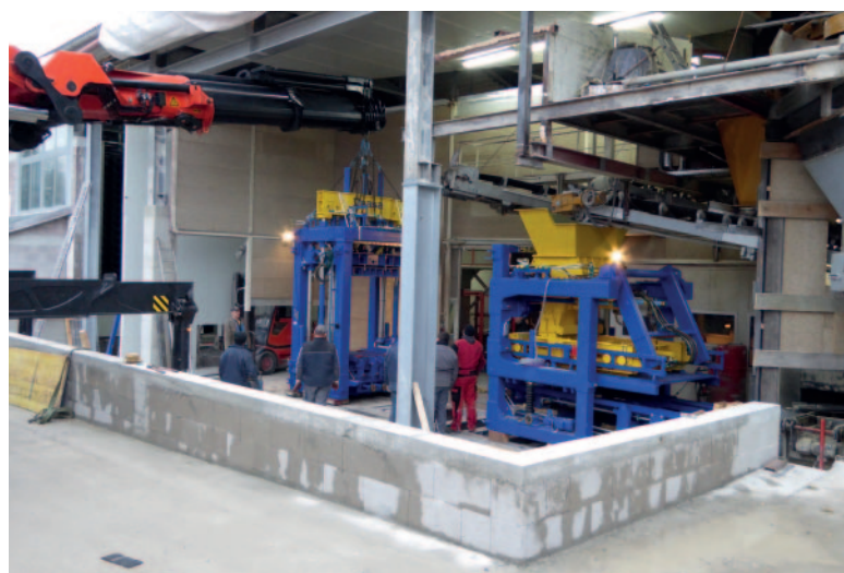
L'élément de compactage de la nouvelle Masa XL9.1 est installé.
