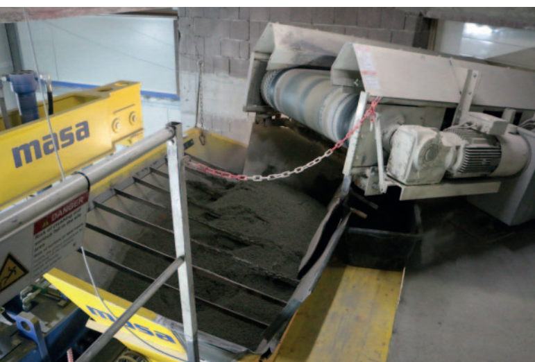
Bande d'alimentation du silo à béton de corps
