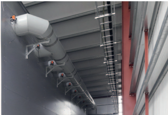
Des tuyaux en GRP (plastique renforcé de fibre de verre) amènent la chaleur dans chacune des chambres - sans corrosion, même sur le long terme.
