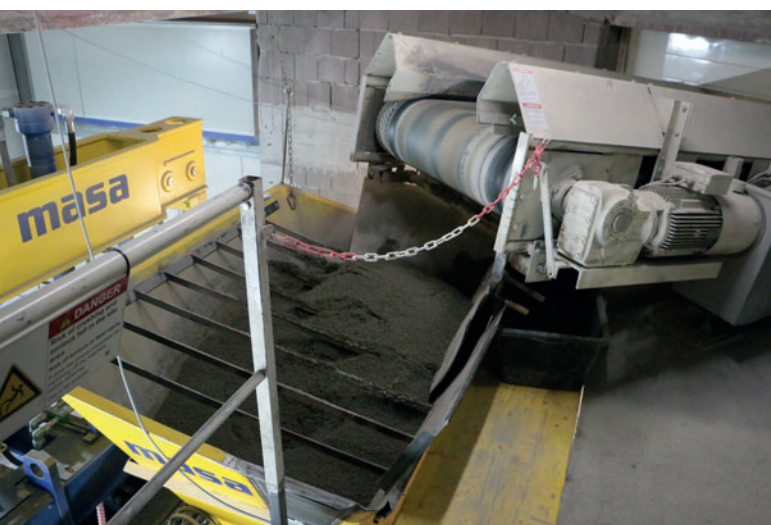
Alimentación por cinta del silo de hormigón monocapa
