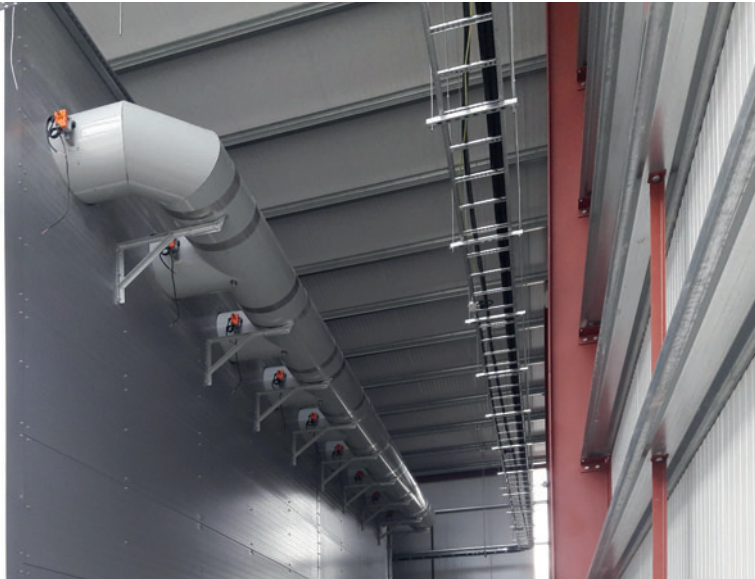
Las tuberías aisladas de PRFV conducen el calor a cada una de las cámaras, además sin corrosión durante mucho tiempo
