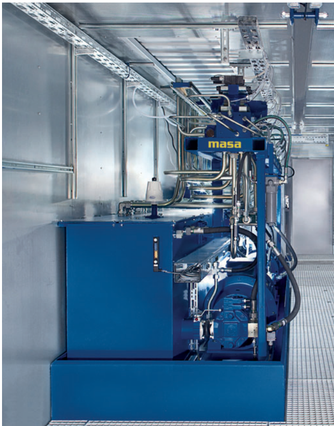
Alles an seinem Platz: Die Masa Combitainer-Lösung für Hydrauliksystem und Schaltschränke
