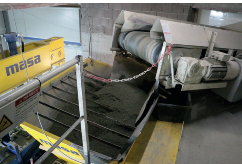
Bandbeschickung des Kernbetonsilos
