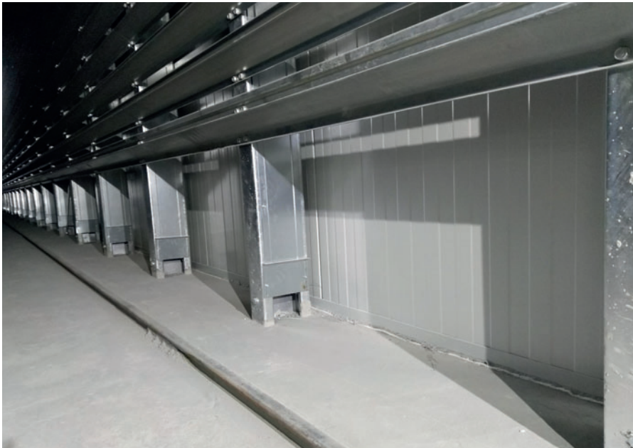
Fig. 5: Mediante la integración de todos los pilares en la pared de la cámara, la estantería de Kraft traslada el punto de rocío de la losa del suelo hacia fuera, evitando así la condensación y la corrosión. (Fotografía: Kraft Curing Systems)
