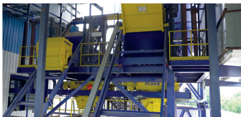
Elevatori per aggregati alle autobetoniere Masa
