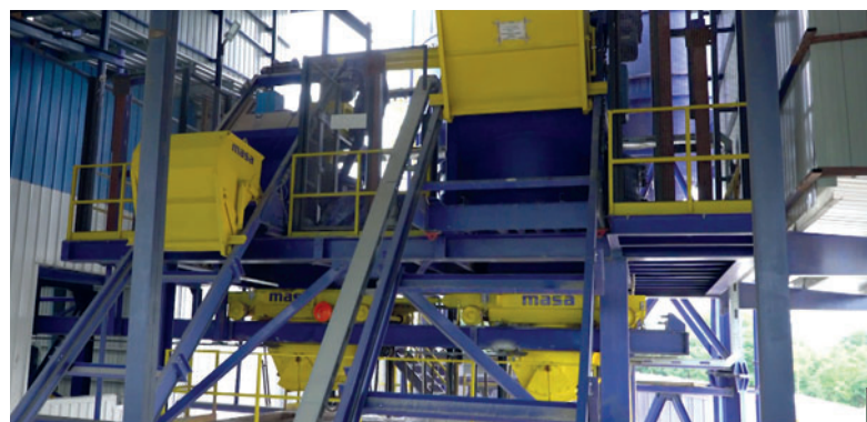
Zuschlagstoffaufzüge zu den Masa-Betonmischern
