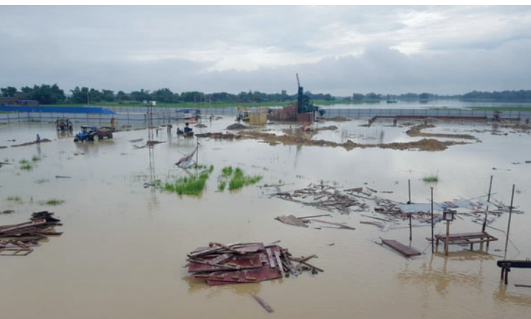
Überschwemmung des Geländes nach heftigem Monsunregen
