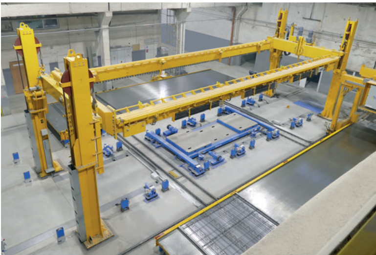
Die Paletten-Wendeeinrichtung ist das neue Herzstück der Doppelwandproduktion der Palettenumlaufanlage.
