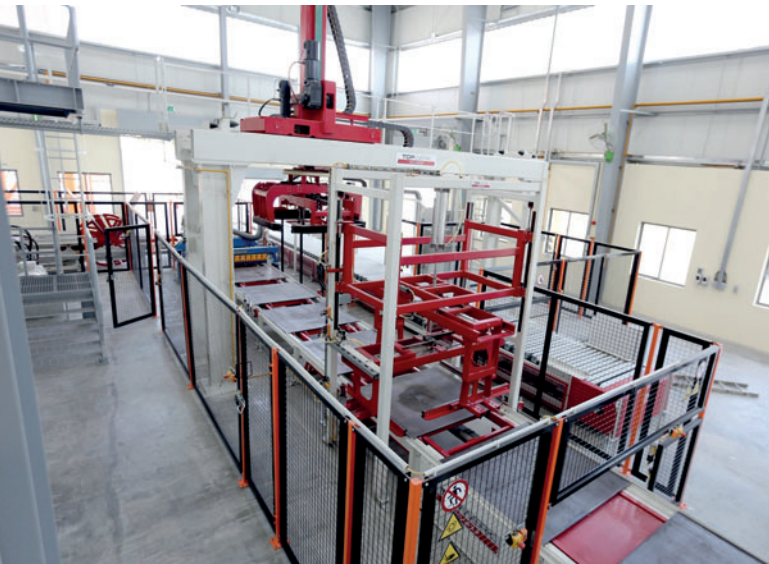
Sistema di trasferimento e movimentazione completamente automatizzato
