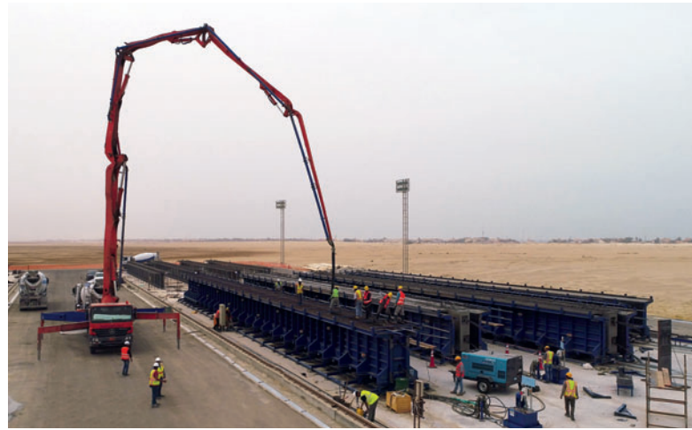
Les moules permettent de fabriquer des éléments de 40 à 45,5 m de longueur, qui peuvent être adaptés à la dimension requise.
