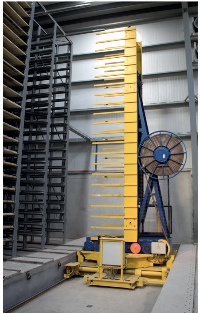
Le système intégré de ventilation Masa favorise qualitativement le processus de durcissement des produits en générant des conditions climatiques homogènes dans les chambres de durcissement.
