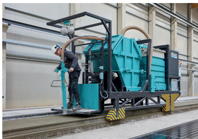
Una sierra multiangular, una sierra para hormigón fresco, un trazador automático, un distribuidor de hormigón, una aspiradora y un carro multifunción completan el equipamiento de producción suministrado por Echo Precast
