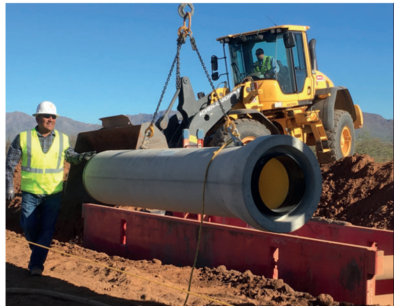
Instalación de Perfect Pipe en Pima County, Arizona, en el año 2017: se instaló y pusieron en funcionamiento un número considerable de tubos DN400
