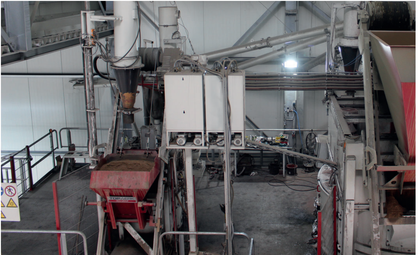
Per la produzione del calcestruzzo sulla piattaforma di miscelazione sono stati installati due miscelatori a regime forzato della serie SM di Hess.
