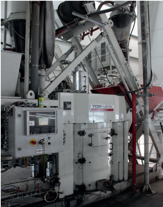
Il miscelatore Hess SM 400 produce il calcestruzzo per lo strato di rivestimento.
