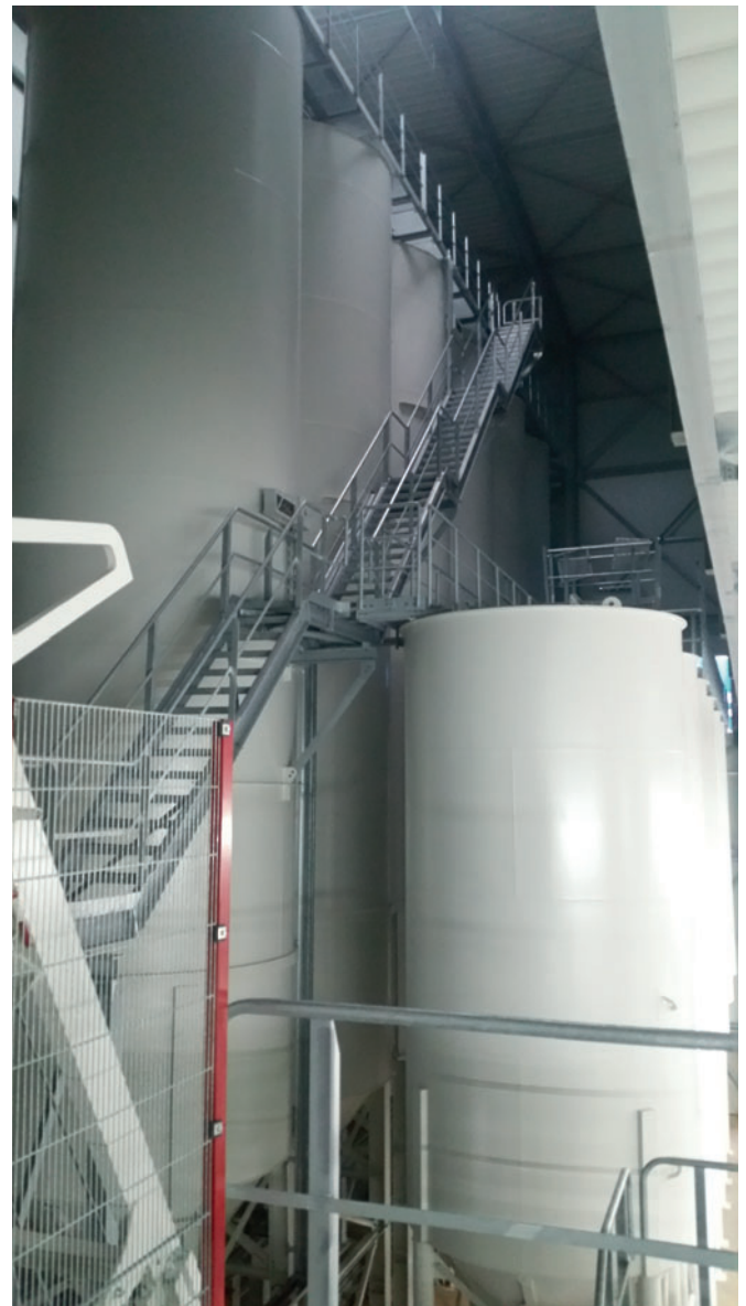
Disposizione dei 12 sili per il calcestruzzo per lo strato interno e per quello di rivestimento
