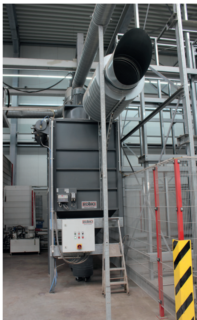
Impianto di depolverazione Dust Control di Rotho
