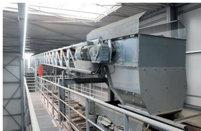
Les granulats pour le béton de corps sont transportés par une nouvelle bande transporteuse provenant du hall principal adjacent.
