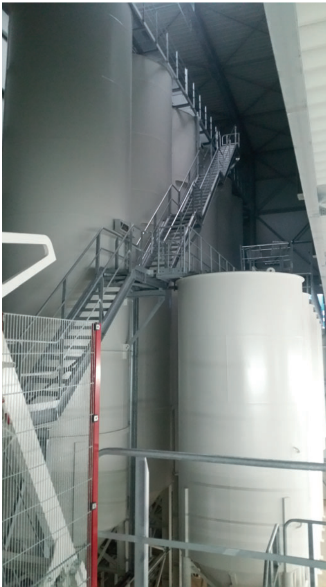
Disposition des 12 silos pour béton de corps et béton de parement
