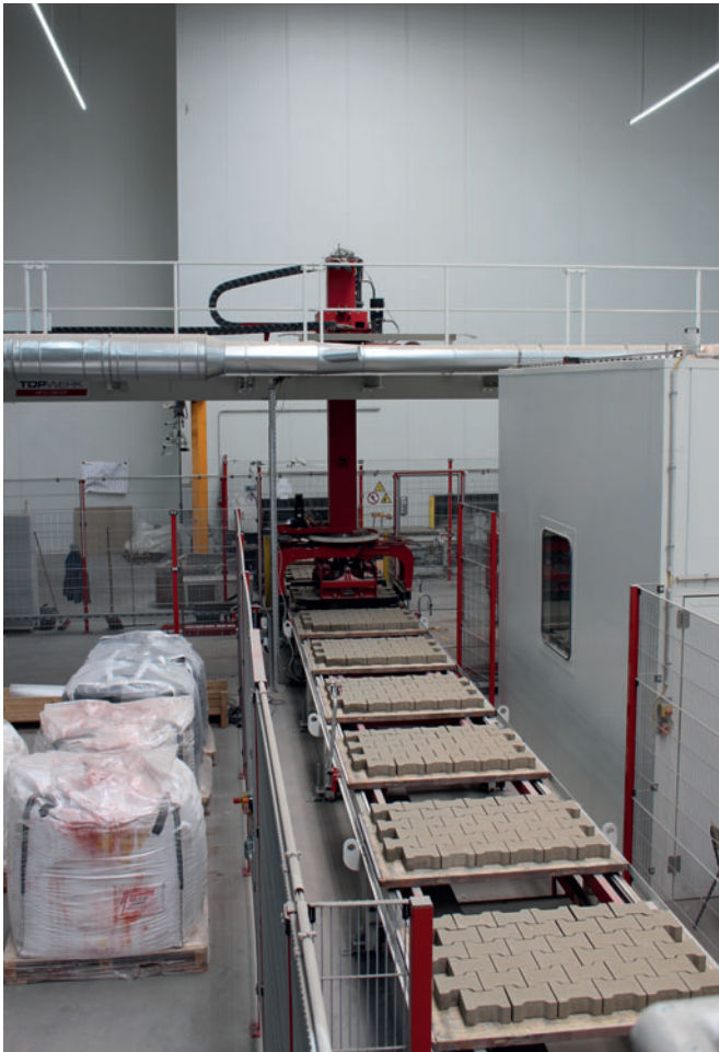
Le premier empaqueteur est aménagé derrière le by-pass. Il sert de séparateur de blocs ou alimente l'installation de finition SR-Schindler en produits en béton.
