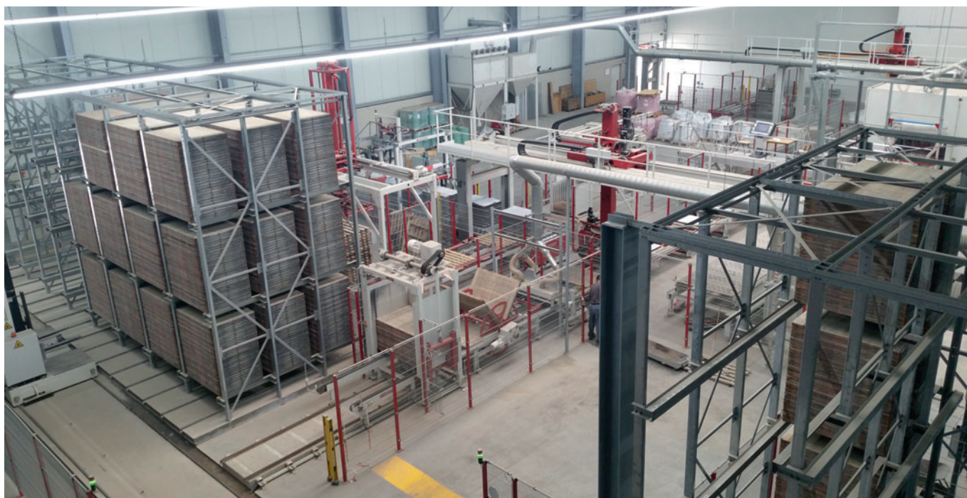
Vue de l'installation côté sec avec le tampon de planches
