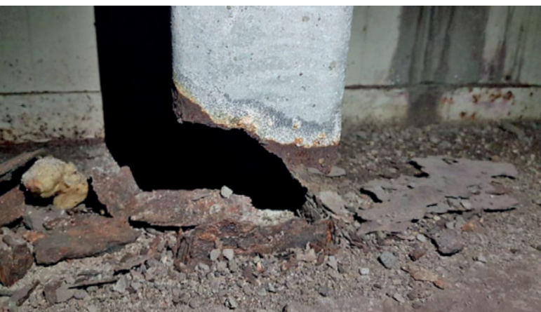
Pilar oxidado debido a la condensación. Este pilar está sostenido por el resto de la construcción y se debe cambiar
