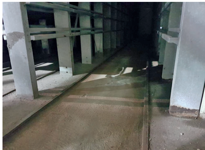
Efecto típico de la condensación: los pilares del interior no tienen óxido, pero los pilares situados al lado de la pared [derecha] están corroídos en su parte inferior
