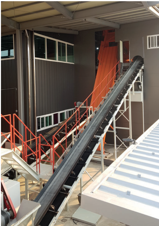
Дозирующий транспортер под бункерами взвешивает инертные для опорной бетонной смеси и подает их на ковшовый подъемник
