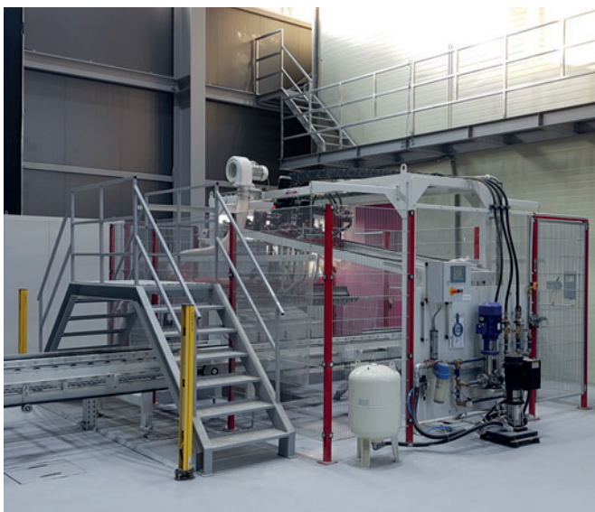
In den Transport auf der Nassseite ist ein Doppelauswaschgerät eingebaut.
