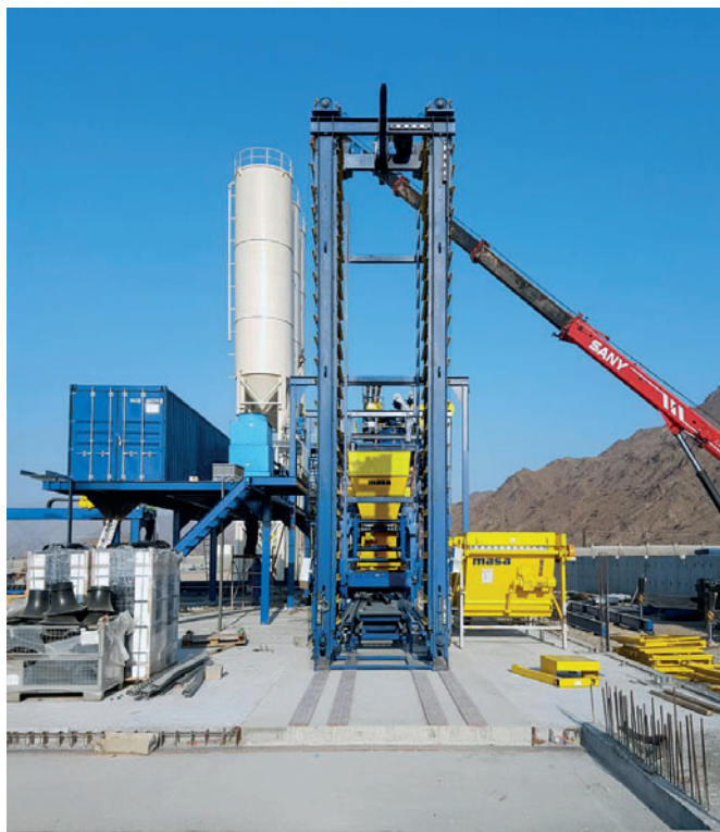
La nouvelle installation de production de blocs de béton lors du montage : les principaux composants sont déjà en place.
