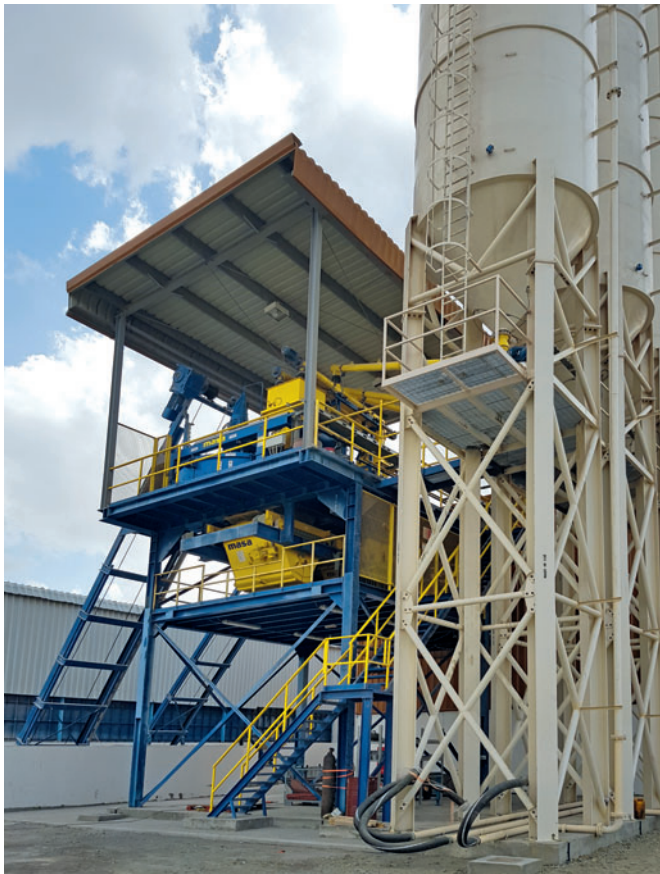
Installation de mélange avec les malaxeurs Masa PH 2000/3000 et PH 500/750, à l'extérieur.
