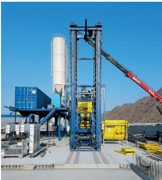
La nueva instalación de fabricación de bloques de hormigón durante el montaje: Los componentes principales ya están listos.
