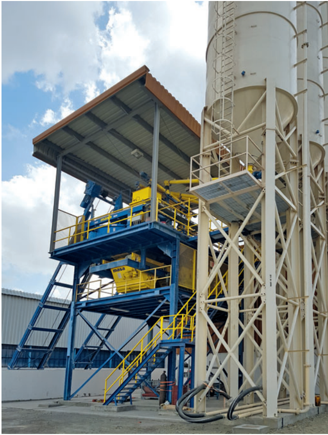
La instalación de mezcla, compuesta por las mezcladoras Masa PH 2000/3000 y PH 500/750, en la zona exterior.
