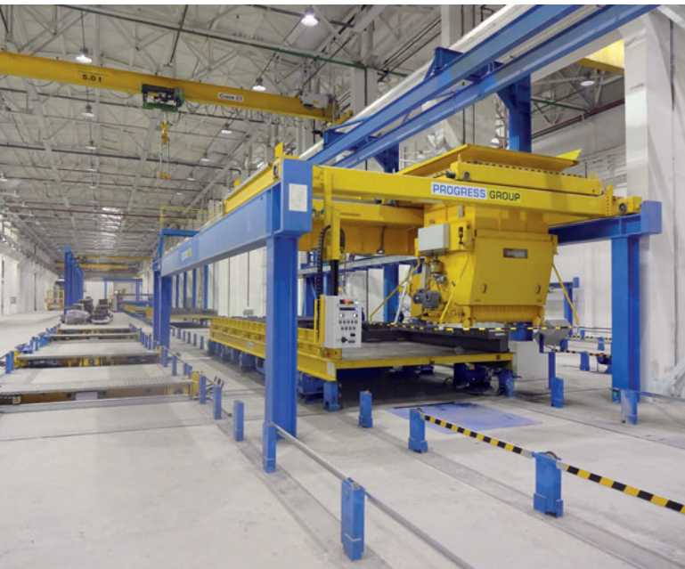
Con la instalación de circulación de bandejas de EBAWE Anlagentechnik, Erel dispone de un total de 41 bandejas de producción.
