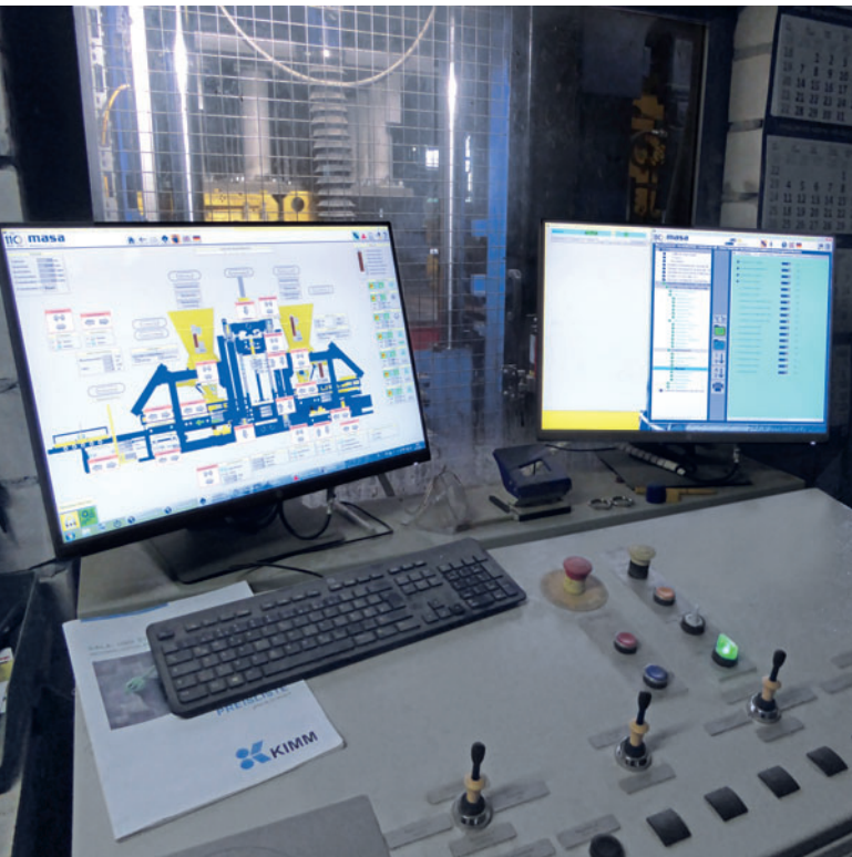
El software modular de control de la instalación Masa para un manejo y una visualización unitarios de los componentes se completó con una interfaz de transferencia de datos.
