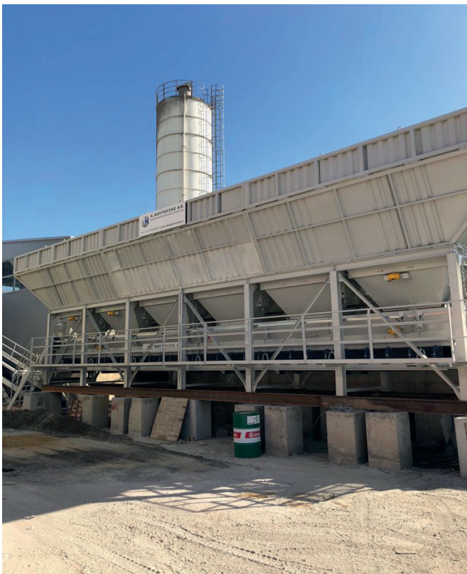
Instalación dosificadora de Koutousis S.A.
