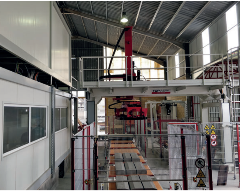
Lado seco con empaquetadora eléctrica Topwerk
