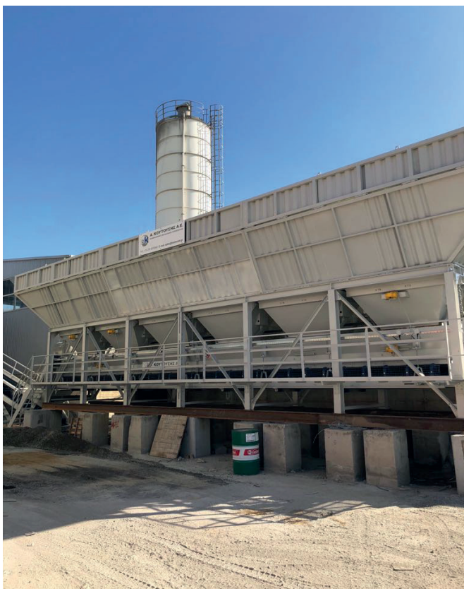
Dosieranlage von Koutousis S.A.
