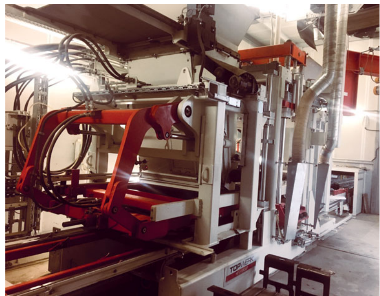
El corazón de la instalación es la máquina de alto rendimiento RH 1500 MVA
