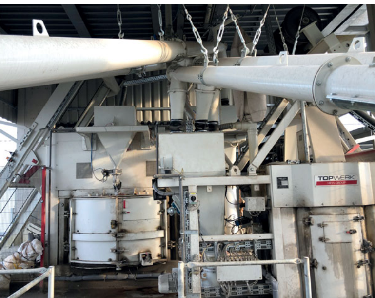
Para la producción de hormigón se instalaron una mezcladora de hormigón Hess SM 2250 para el hormigón monocapa y una mezcladora de hormigón Hess SM 400 para el hormigón bicapa.
