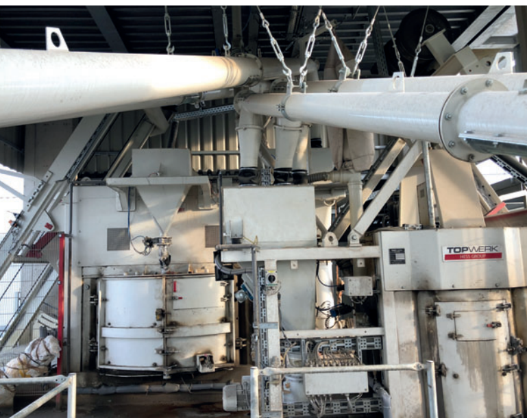
Zur Betonherstellung wurden ein Hess SM 2250 Betonmischer für den Kernbeton und ein Hess SM 400 Betonmischer für den Vorsatzbeton eingebaut.
