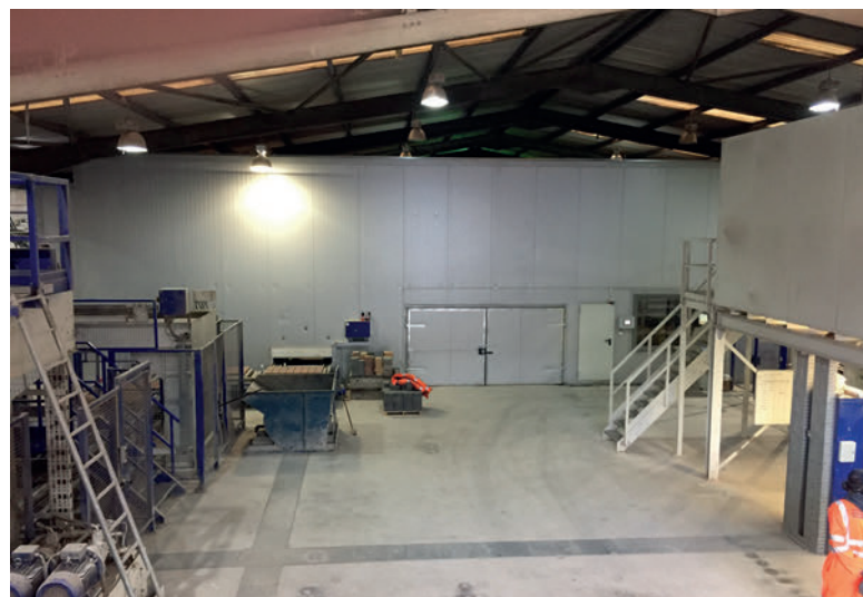
Изолированная рабочая зона транспортировочной платформы с подъемником и опускным устройством. Двойные ворота для доступа устройств, дверца для людей и большое окно
