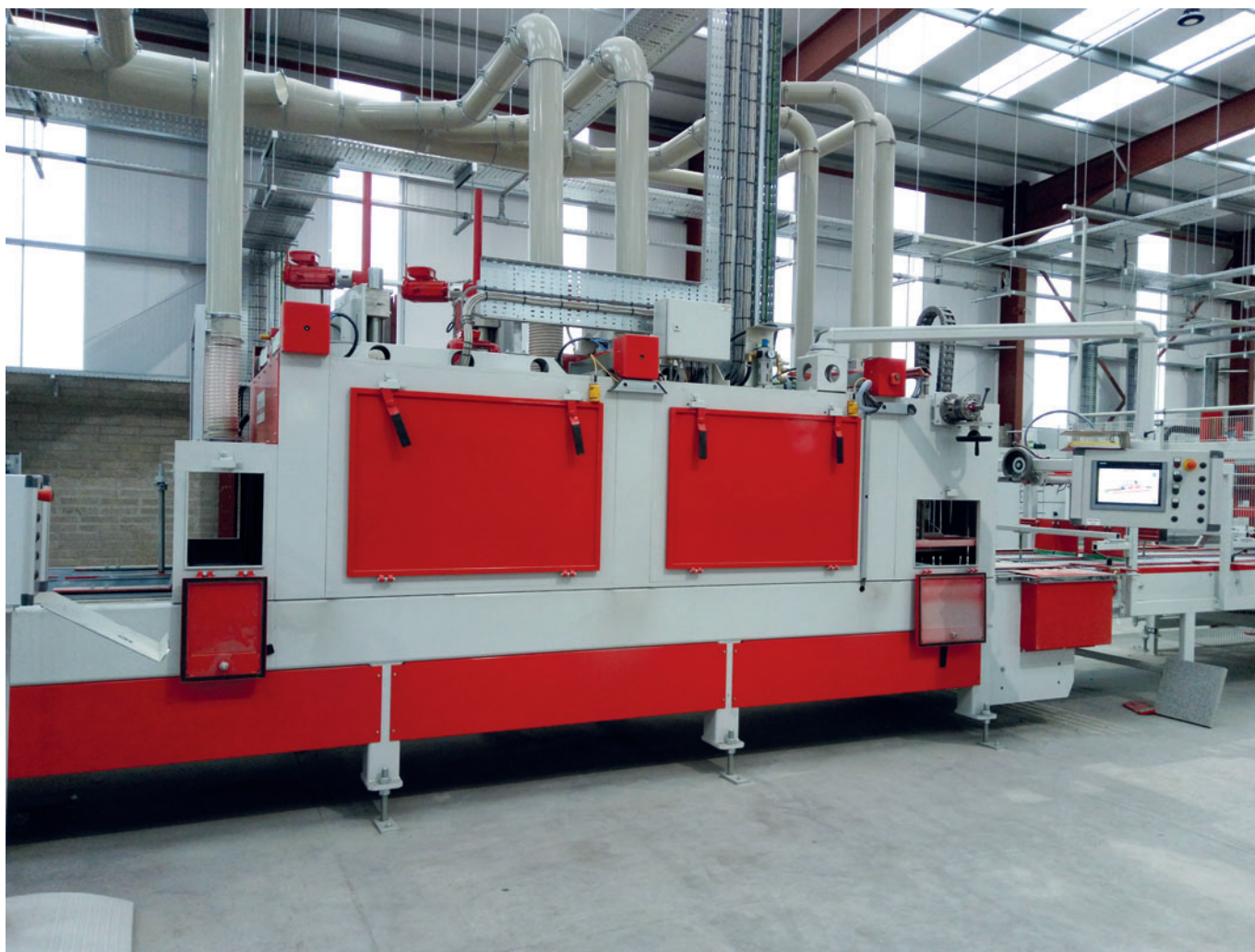
Dans la machine de curling aussi, les guidages latéraux peuvent être adaptés à différentes largeurs du produit par voie électrique dans la commande par impulsions.
