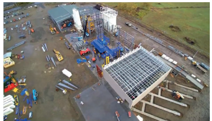
Il capannone di produzione con una superficie di base di 9.700 m 2 durante la costruzione
