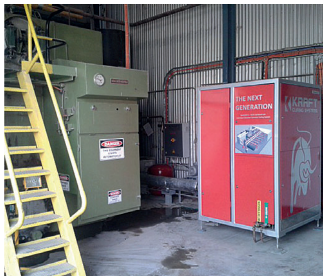
Con el generador de vapor no solo se puede ahorrar dinero sino también espacio. Aquí se muestra junto a la caldera de vapor que ha sustituido.
