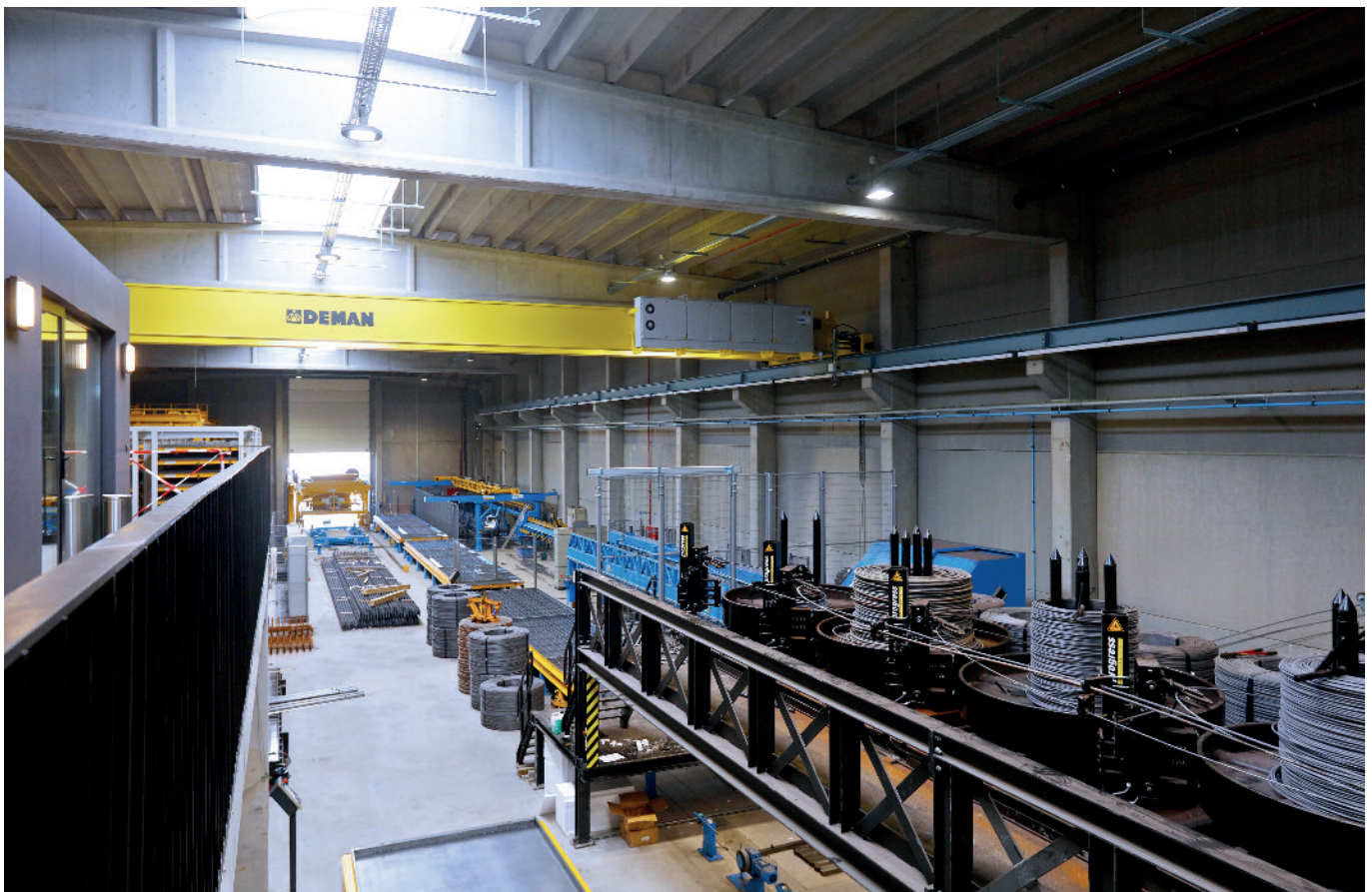
Linię technologiczną zamontowano na bardzo małej powierzchni i zautomatyzowano w niej istotne operacje.
