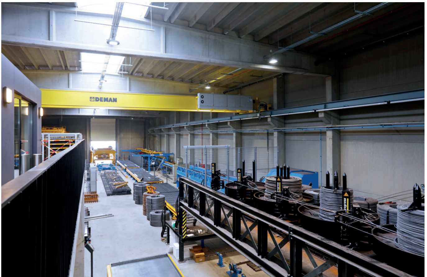
El sistema de carrusel se ha instalado en un espacio muy reducido y automatiza importantes pasos de trabajo
