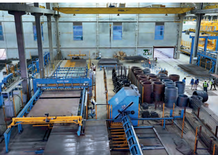
Die drei für die Bewehrungsfertigung installierten Anlagen (im Bild die Mattenschweißanlage) tragen dank ihrer Effizienz zu einer sehr guten Produktionskontinuität bei.
