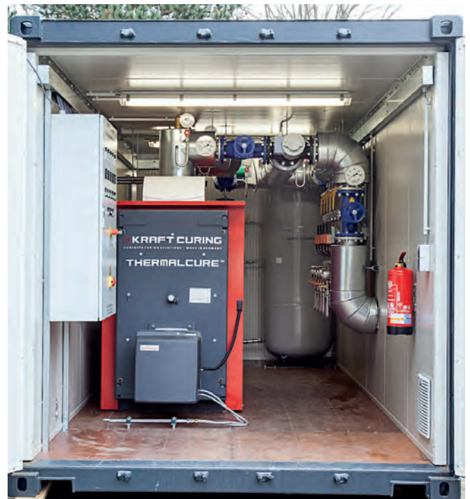
Für das aktuelle Projekt Albvorlandtunnel liefert Kraft das beschleunigte Betonhärtungssystem Thermalcure®, wobei das Herzstück (Heißwasserkessel) der Anlage in einem isolierten, belüfteten und beheizten Container verbaut ist.
