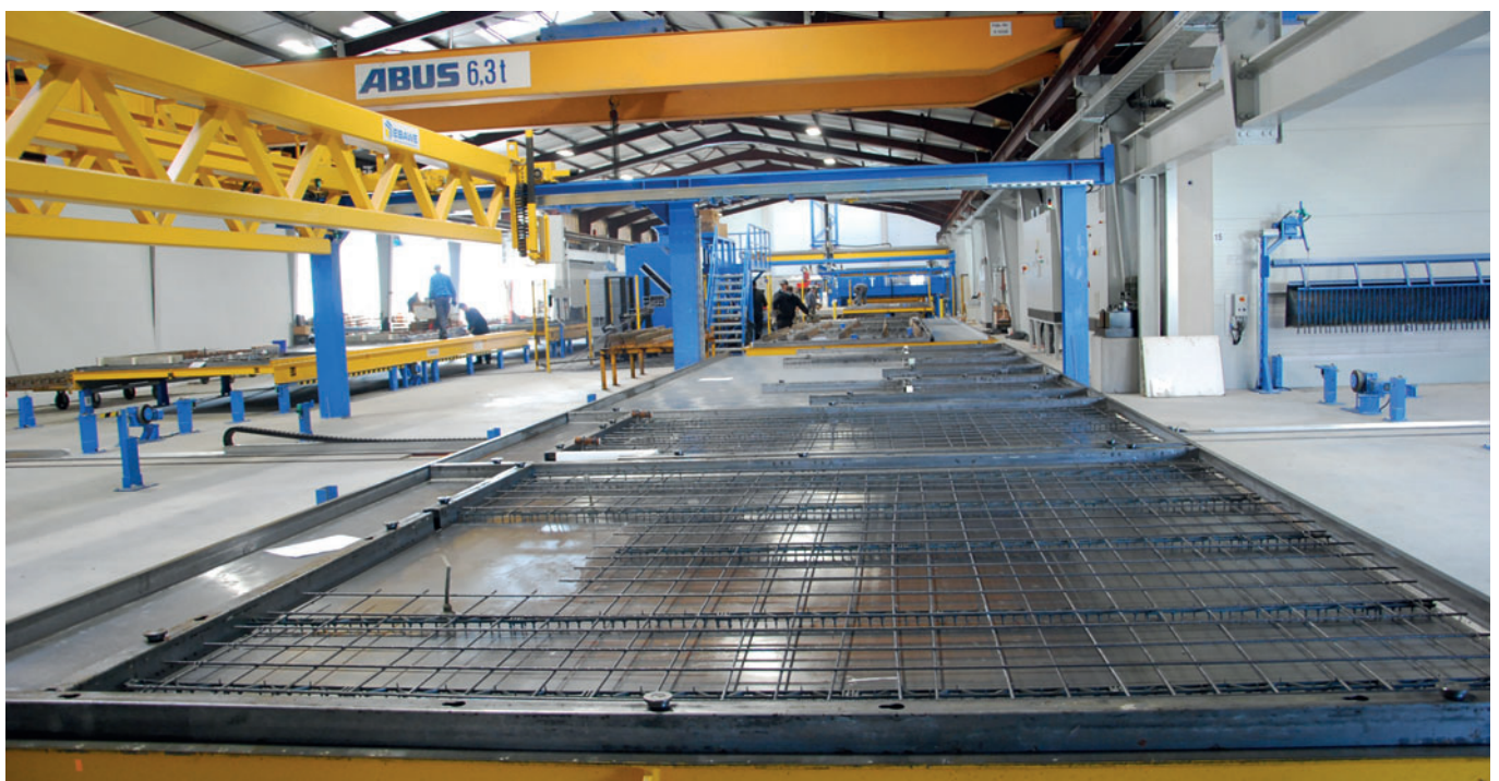
La nuova costruzione dell'impianto a carosello di pallet ha consentito a Regenold di aumentare la produttività e ridurre i costi di esercizio.
