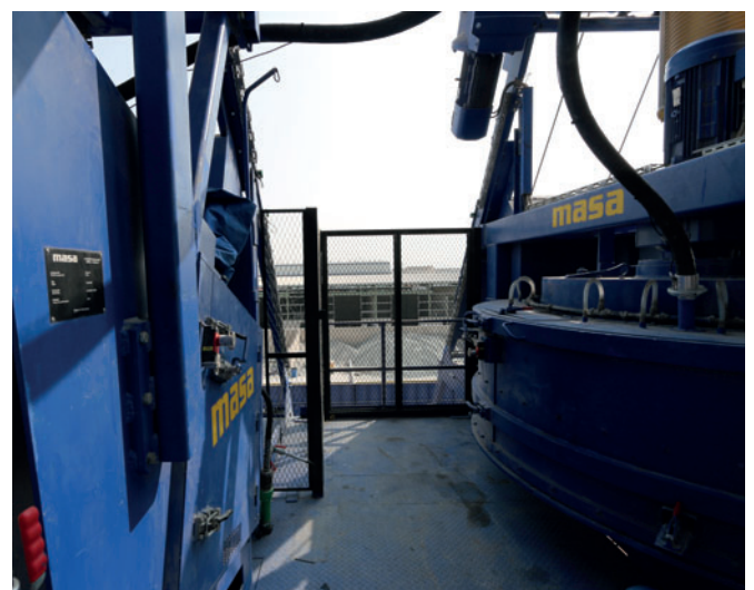
La nouvelle usine est équipée de deux mélangeurs de béton fournis par la société Masa : mélangeur Masa PH 2000/3000 (à droite) et mélangeur Masa S 350/500 (à gauche)
