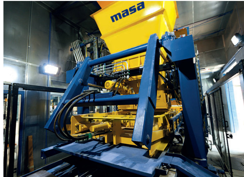
Le cœur de la nouvelle installation : Installation de production de blocs en béton Masa XL 9.1
