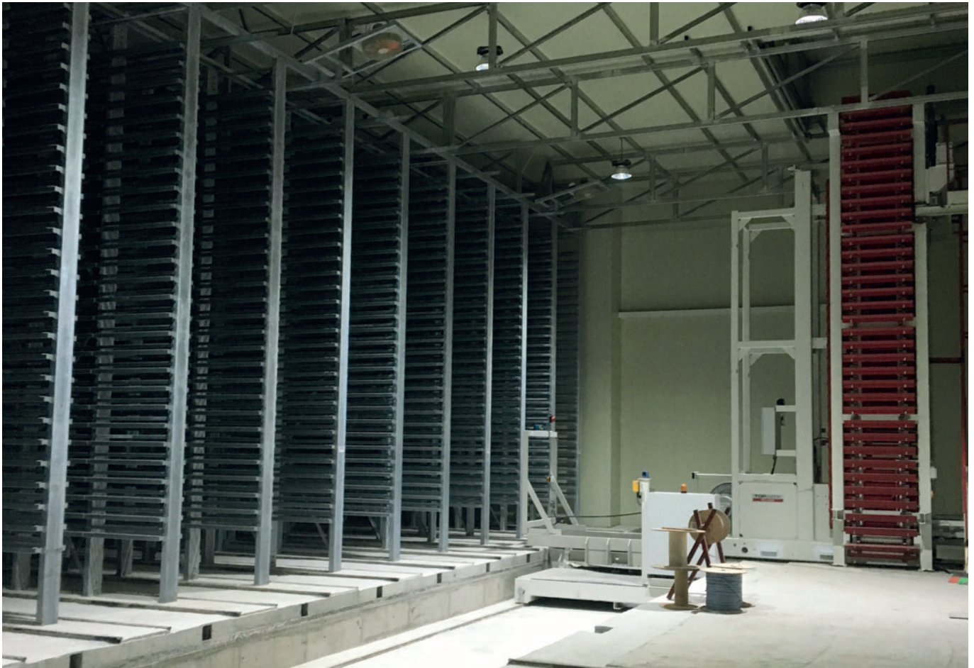
La chambre de durcissement a été aménagée par la société Rotho.
