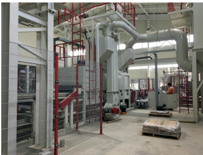
Pour le processus de finition, la société Duksan Co. Ltd. a livré une installation de grenailage, tandis que la société Topwerk a fourni les empaqueurs et les installations tampons.
