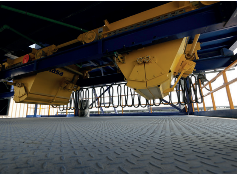
Vorsatz- und Kernbeton werden mit der Masa Kübelbahnanlage zu den Silos der Betonsteinfertigungsmaschine transportiert.
