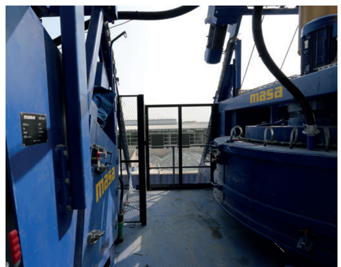
Das neue Werk ist mit zwei Betonmischern aus dem Hause Masa ausgestattet: Masa Mischer PH 2000/3000 (r.) und Masa Mischer S 350/500 (l.)
