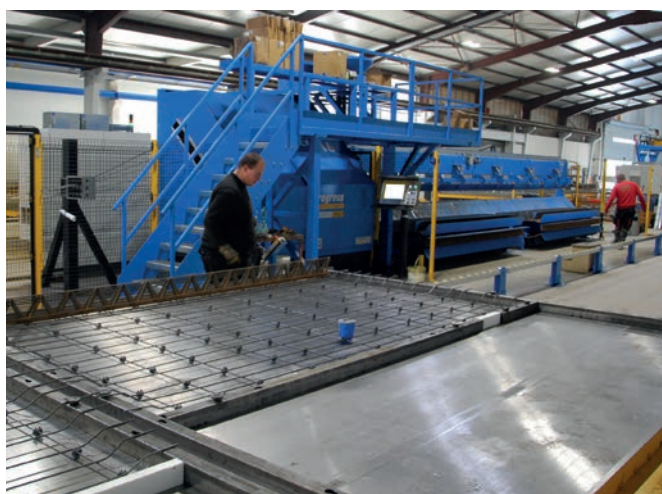
新生产线配备了 MSR16 BK 型钢筋矫直、切割和弯曲机。与钢筋桁架叠合楼板类似，手动插入生产的钢筋
