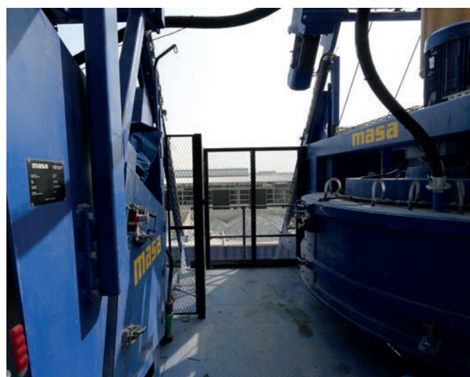
新工厂配备两个 Masa 混凝土搅拌机：Masa PH 2000/3000 型搅拌机 (右) 和 Masa S 350/500 型搅拌机 (左)
