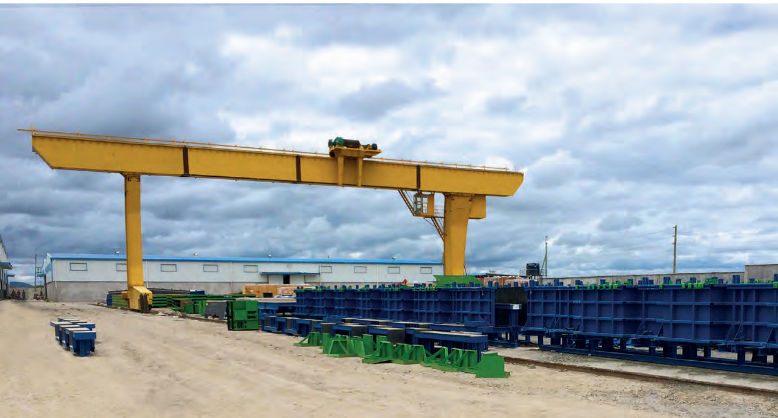
Опалубочные формы длиной 8 м каждая используются для изготовления опор для объектов коммерческого строительства
