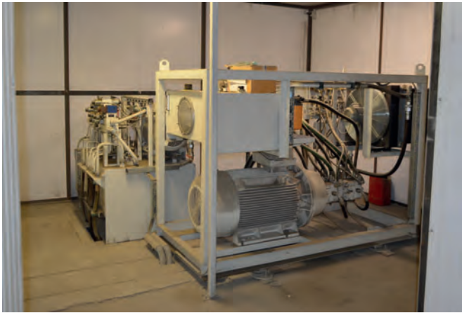
Vano sistema idraulico
