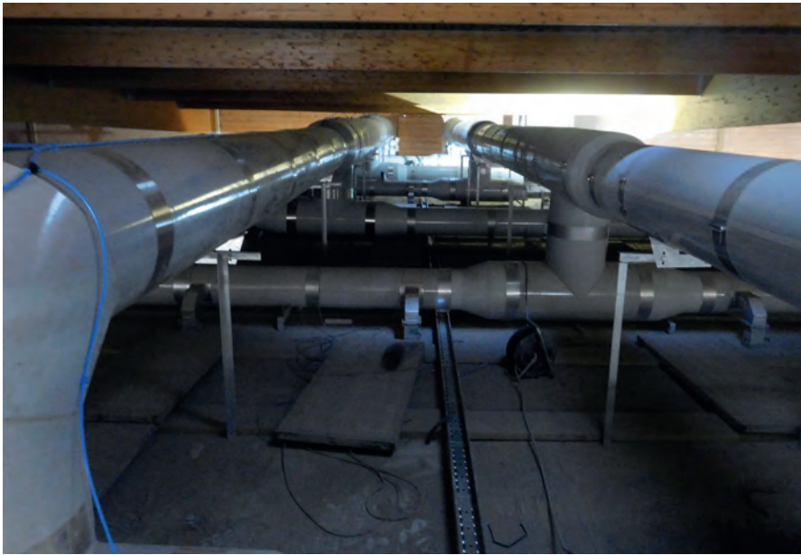
Теплоизолированный воздуховод над камерой с высокопроизводительными увлажняющими форсунками
