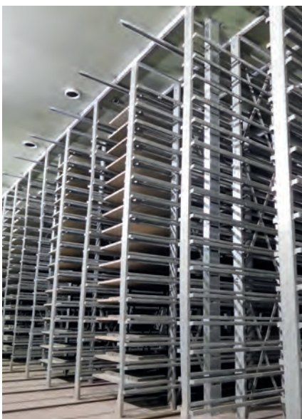
Распределительный воздуховод внутри камеры для регулирования воздушного потока и ограничения его скорости до 1\text{ м/с}
