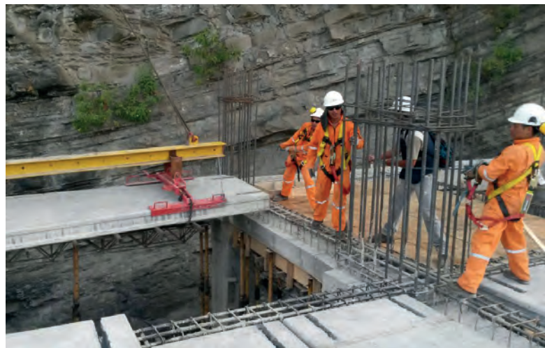
Компания EPCE поставила преднапряженные ж/б перекрытия длиной 8 м общей площадью 10 000 м 2 с завода в Риоамбе на объект в крупнейшем городе Эквадора
