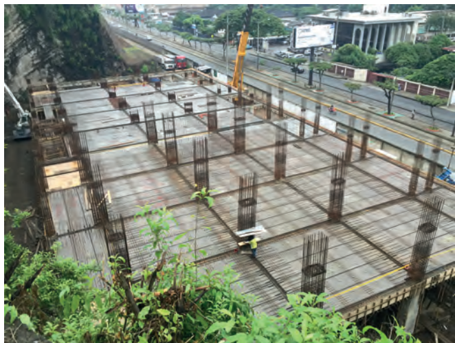
В августе этого года в Гуаякиле было построено 5-ярусное здание парковки Католического университета. Планируется наращивание высоты до 7 ярусов
