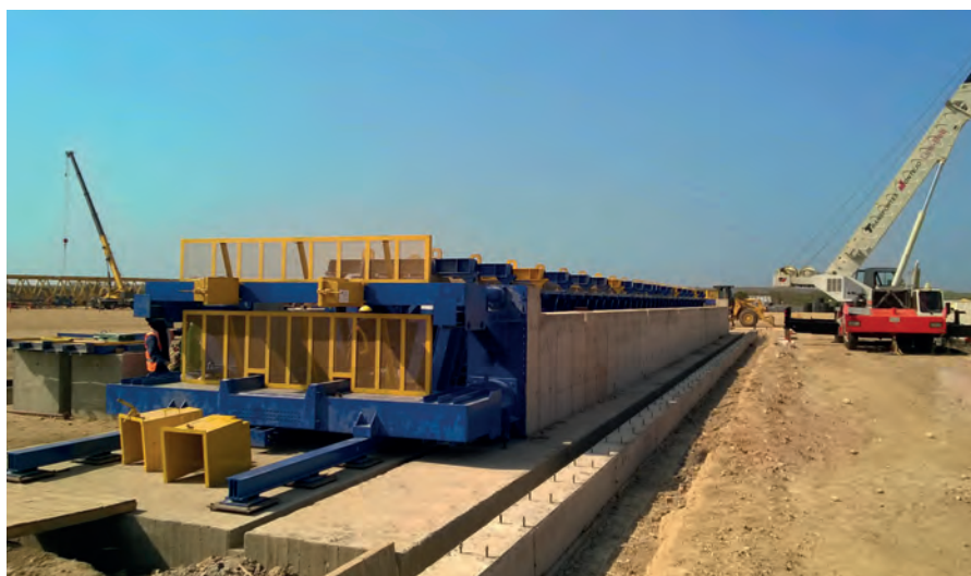
Опалубочная форма длиной 40 м была смонтирована недалеко от стройплощадки. Она работает автономно благодаря системе для восприятия усилий предварительного напряжения
