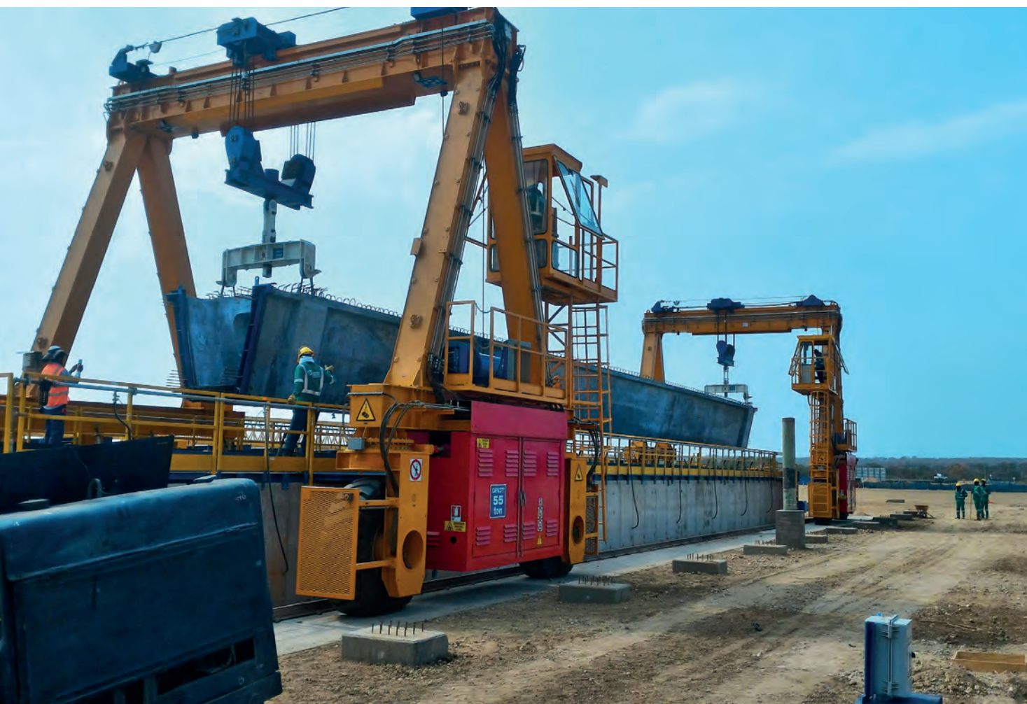
При помощи двух мостовых кранов 387 бетонных элементов погружаются на специальные платформы, которые доставляют их на стройплощадку
